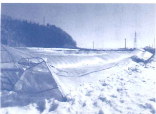
大雪で倒壊したハウス
